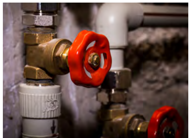
Fragment instalacji sanitarnej | fot. Adobe Stock
